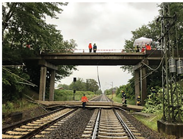
Abb. 2: Im Jahre 2020 stürzte eine Brückenkappe einer kommunalen Brücke in Nordrhein-Westfalen auf die Bahngleise. Ursache war die Korrosion der Verankerung. Zum Glück gab es keine Personenschäden bzw. Schäden an einem Zug der Deutschen Bahn.
