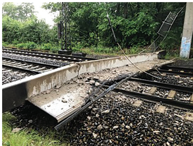
Abb. 3: Die verantwortliche Kommune hatte einen Bauwerksprüfingenieur 2016 mit der notwendigen Hauptprüfung beauftragt. Zu dieser Zeit gab es keine wesentlichen Mängel. Allerdings ist die 2019 erforderliche einfache Prüfung nicht durchgeführt worden. Dabei hätte laut Gutachter dieser Schaden nicht erkannt werden können.
