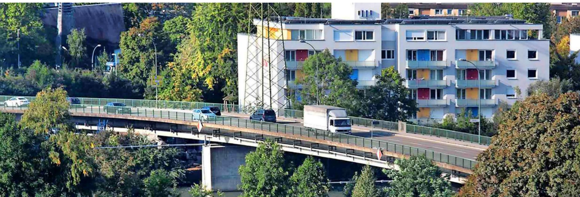
Die Hanns-Martin-Schleyer-Brücke in Esslingen ist dringend sanierungsbedürftig. Der beim Bau 1954 verwendete Stahl für die Seile birgt Gefahren. Er kann ohne Vorwarnung reißen. FOTO: RUDEL
